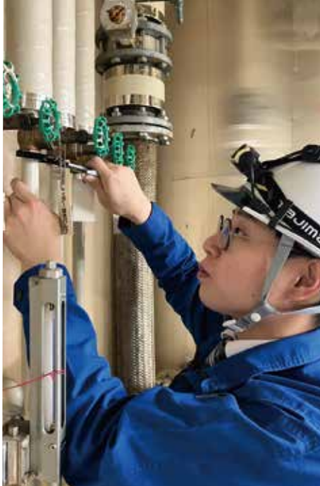
配管設備の点検をする小野さん
