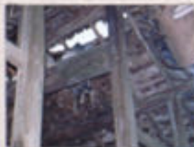
▲屋根が抜けている。
